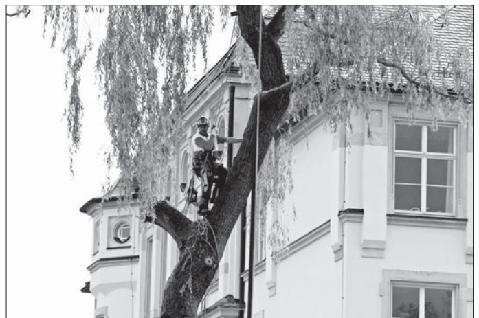
In schwindelerregender Höhe trägt der Profi-Baumsteiger Lars Heinze die große alte Trauerweide auf dem Schulhof der Oberschule Flöha-Plau ab. Weitere Bilder von der Baumfällung finden Sie im Nachrichtblock auf der Website der Stadt Flöha unter www.floeha.de . Foto :rs.
